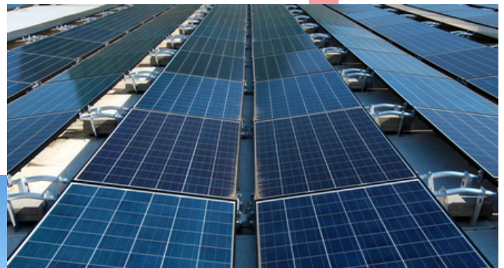
OCC Solar Array
